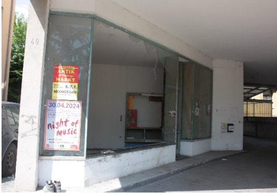
Abbildung 8: Leerstand und Vandalismus in der Weststraße
