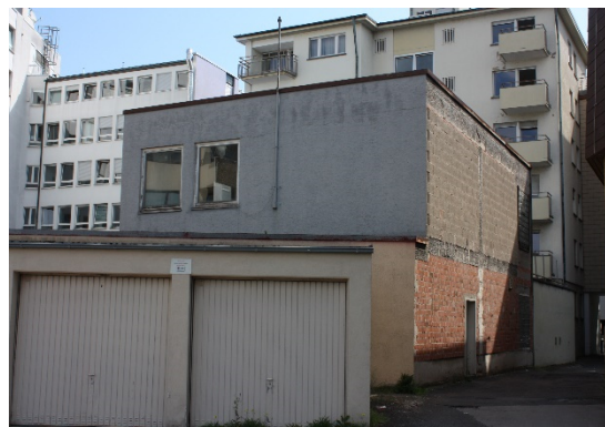
Abbildung 22: Gebäude mit Modernisierungsbedarf sowie Leerstände
