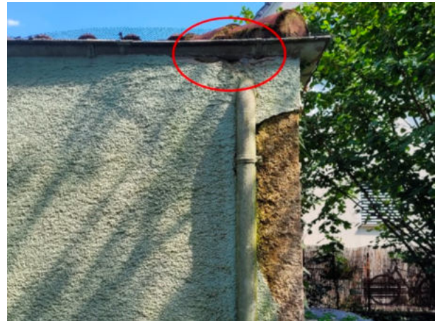
Abb. 20: Spaltöffnung an der südwestlichen Ecke von Gebäude C über dem Fallrohr.
