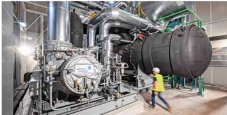
2024 wurde die Großwärmepumpe am Standort Stuttgart-Münster nach einer Probephase in Betrieb genommen, sie dient als Pilot- und Demonstrationstechnologie. Nach Unternehmensangaben liefert sie Fernwärme für 10 000 Haushalte. Foto: EnBW
