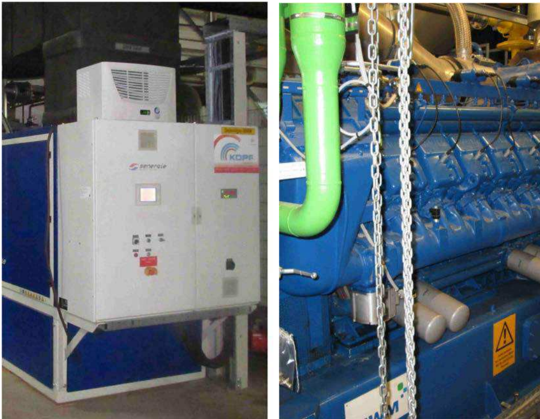
Foto 19 & 20: Deponiegas-BHKW 280 kW el (links) und Gasmotor-BHKW Nennleistung 2000 kW el (rechts) in der Weipertstraße. Die BHKW Zentrale übernimmt die Fernwärmeversorgung in der Nördlichen Innenstadt. Foto ebök.
