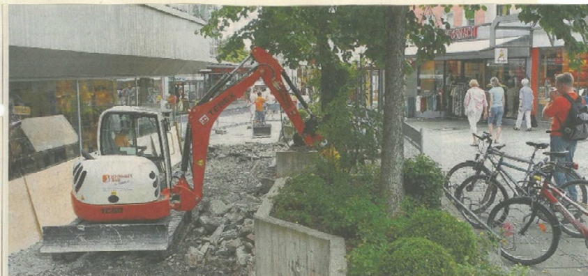
An der Nordflanke des Wollhauses haben die Bauarbeiten zur Aufwertung der Fußgängerzone begonnen. Sie laufen in kleinen Etappen bis Frühjahr 2008. Foto: Vogel
