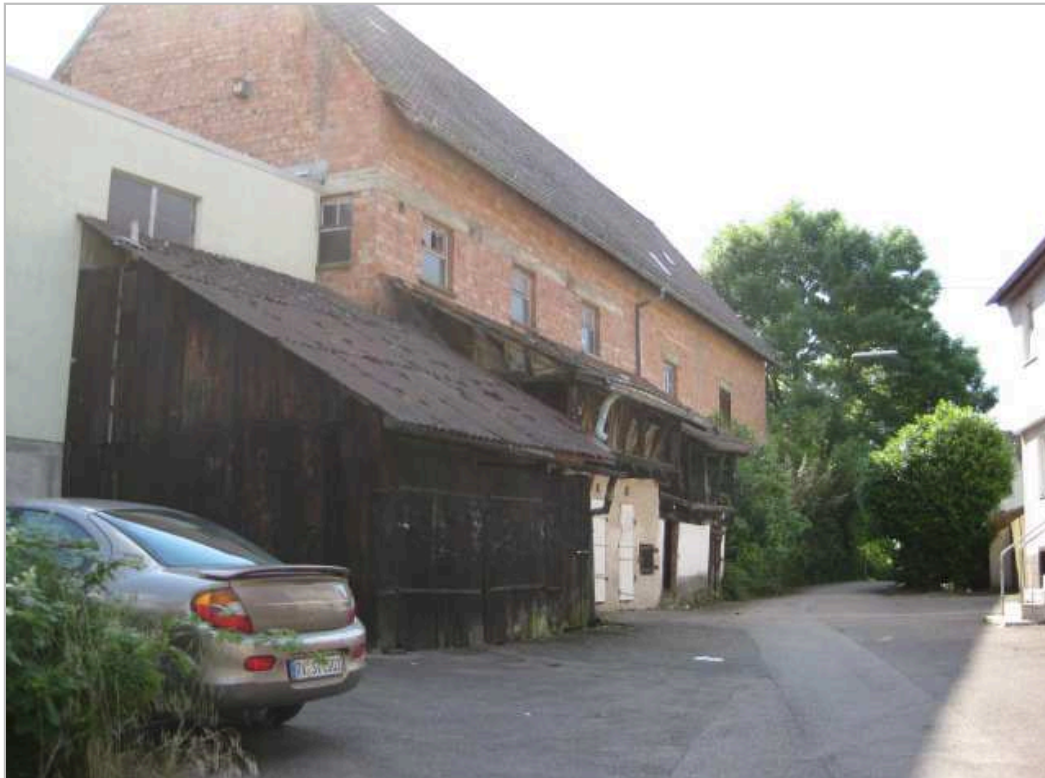
Bild: Rappengasse - vor der Umgestaltung des Straßenraums und vor Abbruch der Nebengebäude/ der Schuppen auf dem Anwesen Rappengasse 6
