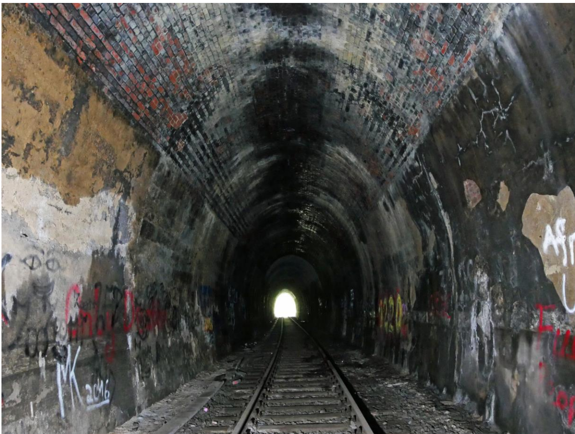
Bild 2: Im Lerchenbergtunnel angetroffener "Regelausbau": Widerlager links und rechts aus Mager- bzw. Einkornbeton, Mauerwerksschale im Gewölbe in der Firste aus kleinformatigem Tonziegelmauerwerk; diverse Stellen im Widerlagerbereich (links und rechts) mit Abplatzungen der Zementspritzputzhaut auf der Betonoberfläche; hier: Station ca. 0+270 m, Blickrichtung nach Norden.
