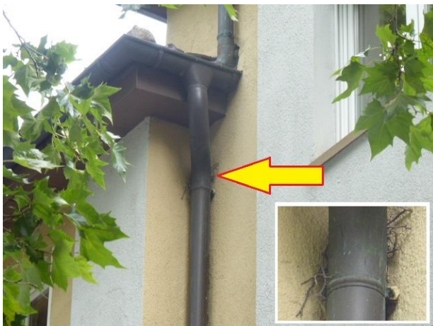
Abb. 13: Dachrinnenhalterung mit verlassenenem Nest an der Westseite von Gebäudeteil 5.
