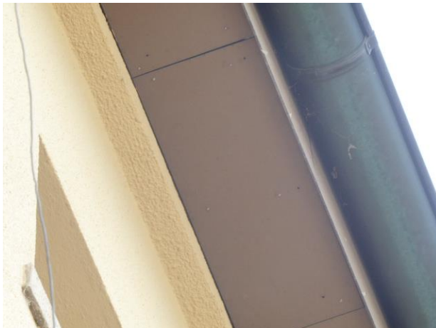
Abb. 11: Schmäler Dachüberstand an Gebäudeteil 5 ohne Nistmöglichkeit oder Spaltenquartiere.
