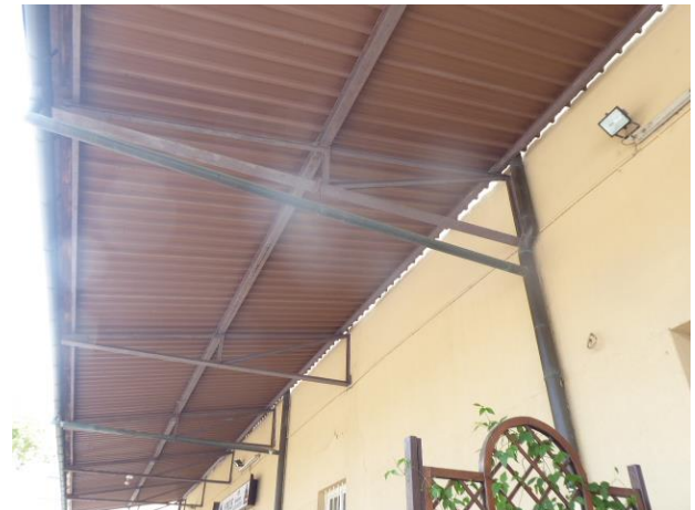
Abb. 12: Überdachung an der Ostseite des Gebäudeteils 5 ohne Nistplatznutzung.
